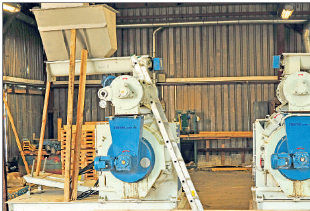
Seit Dezember 2016 läuft im Werk Zaklikow eine Pelletproduktionsanlage (von Tritex, mit Ela-Bandrockner) mit 3 t Kapazität pro Stunde.
